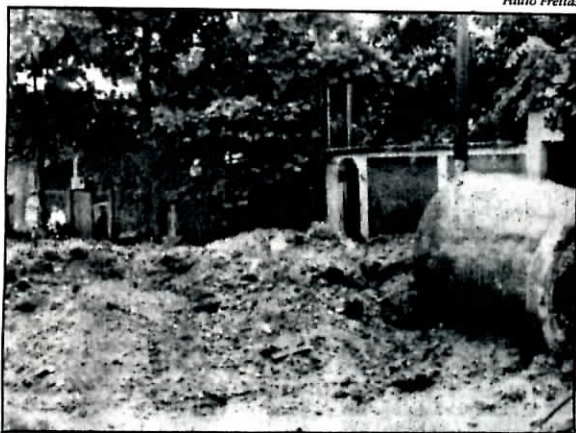
Reclamação é de moradores da Rua João Moreira Sales, no Rádio Clube
